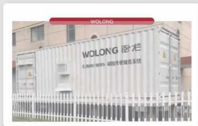
工业厂区用储能系统
