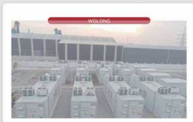
新能源发电侧储能系统
